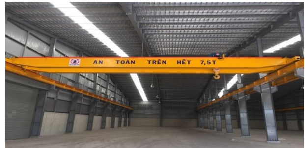
Hình 1. Hệ thống cầu trục trong nhà xưởng
